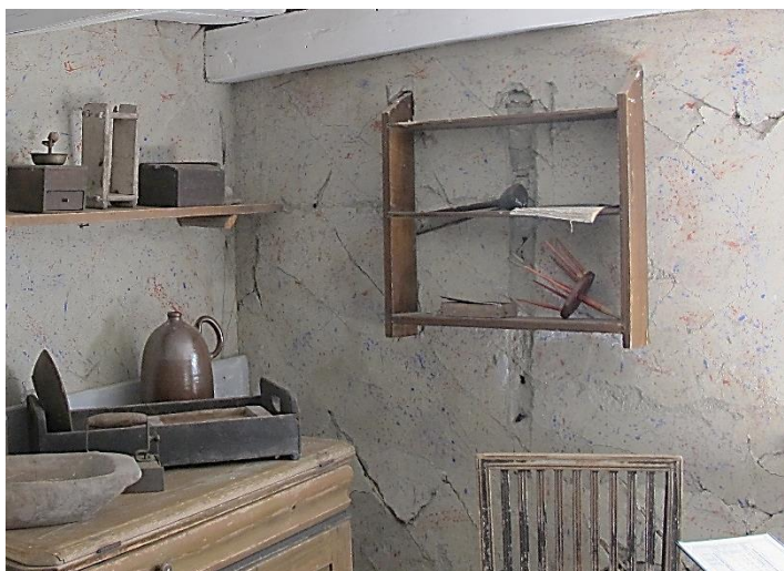
Bilden ovan visar köket före påbörjade arbeten. Väggarnas lerklining var rämnad och satt löst. Foto Hedvig Bellberg 2015-08-27
